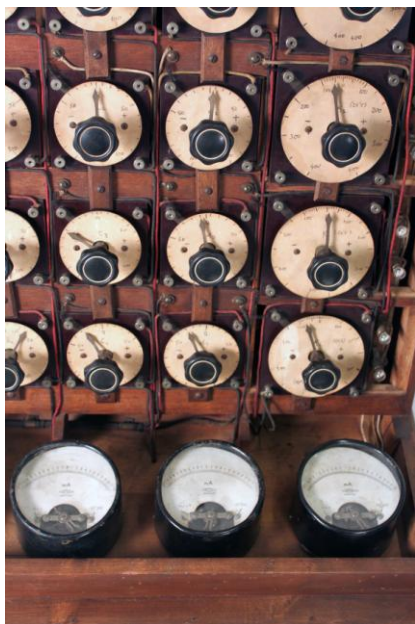
Fotografia 30: Perspectiva des de la qual podem apreciar els elements que hem descrit: la disposició dels reòstats, les cartolines on s'indiquen les magnituds, les bombetes i part del cablejat.
