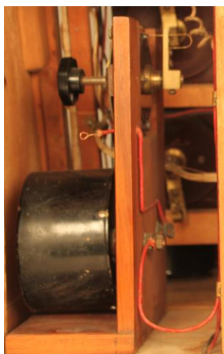
Fotografia 38: Reòstat no connectat i amperímetre que hauria de controlar la intensitat del corrent d'alimentació
