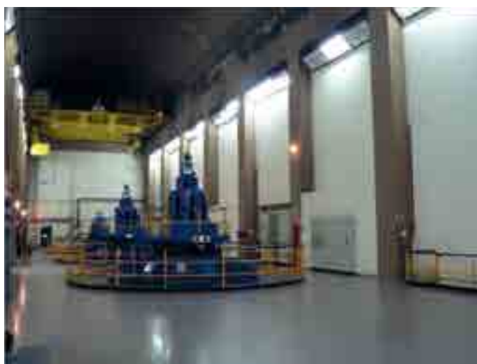
Interior de la central de Tavascan (Pallars Sobirà), construïda per FECSA i en funcionament des del 1971 (FECSA)
