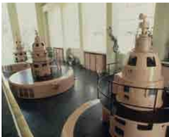
Interior de la central d'Esterrí d'Àneu (Pallars Sobirà), construïda per HECSA i en funcionament des del 1958 (FECSA)
